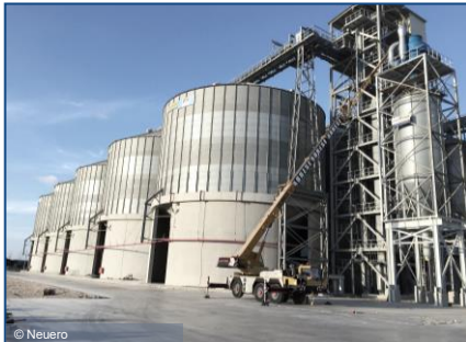
Siloanlage, Damiette, Ägypten
