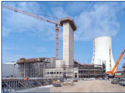
Biomasseheizkraftwerk Stöcken, Hannover
