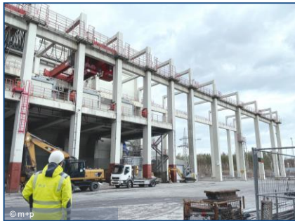
Auspress-Station Müllbunker, TRV EEW, Schöningen
