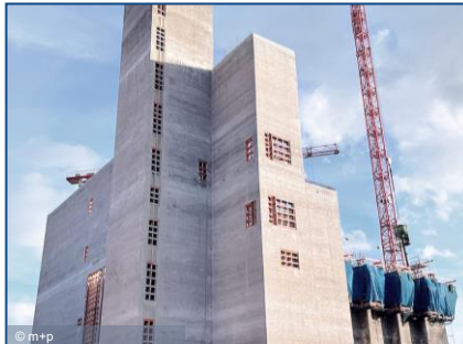
Abfallverwertungsanlage, EEW, Stapelfeld
