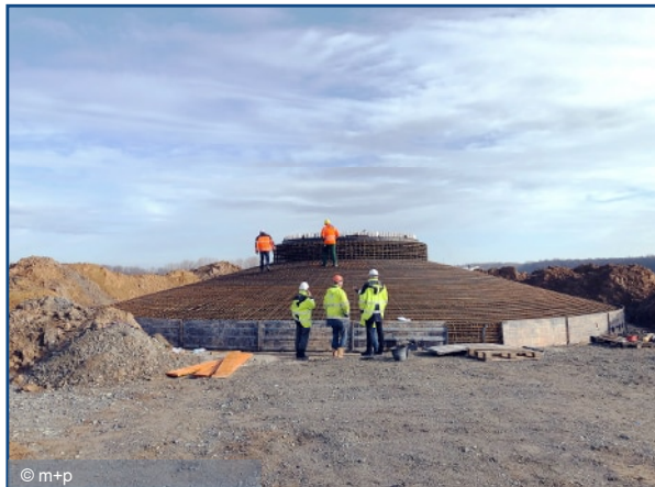
Windkraftanlagen, Salzgitter AG
