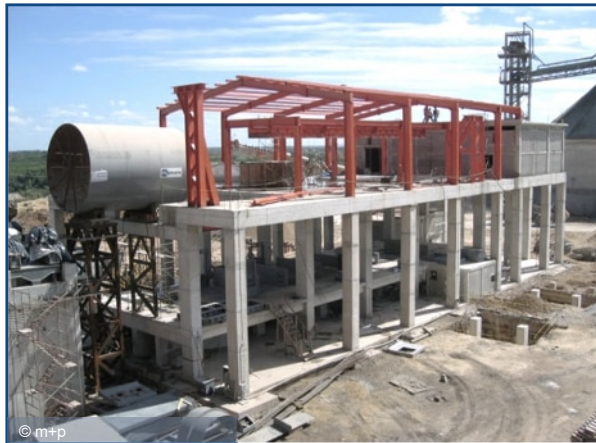
Unterstützungsstruktur Zementkühler, San Pedro de Macoris, Dominikanische Republik
