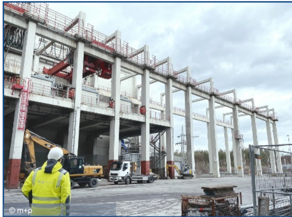
Auspress-Station Müllbunker, TRV EEW, Schöningen
