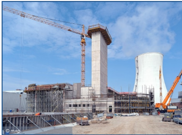
Biomasseheizkraftwerk Stöcken, Hannover
