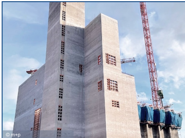
Abfallverwertungsanlage, EEW, Stapelfeld
